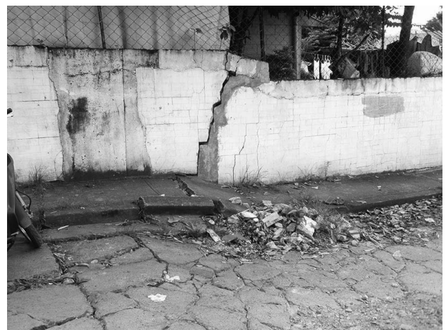
写真1 断層クリープによる変位で生じたブロック塀のクラック
