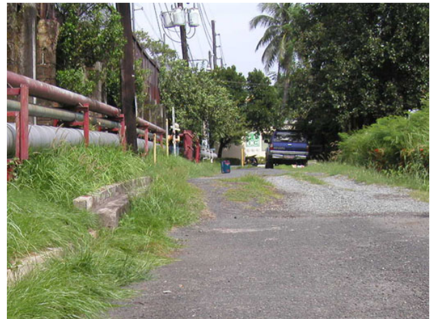
写真1 断層クリープによる変位で生じた道路段差
